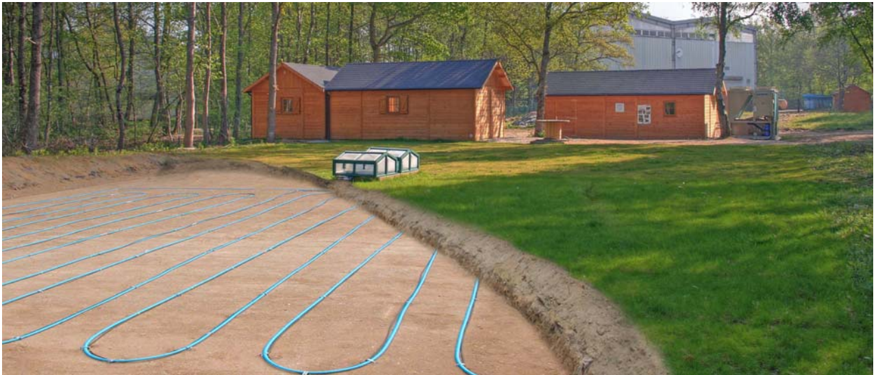
Vue des échangeurs horizontaux
